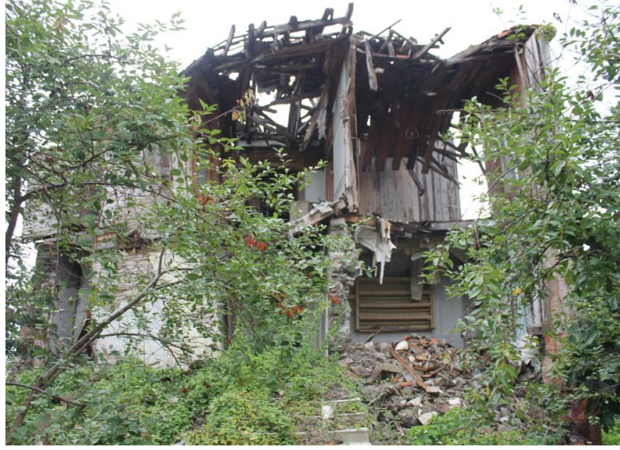
Görsel 19: Tiralizade Emin Bey Konağı Yarı Yıkılmış Hali
