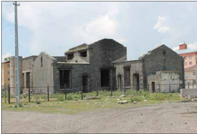
Fotoğraf 6: Tek katlı ve T biçimli Süt Tozu Fabrikası / Single storey and T-shaped Milk Powder Factory
