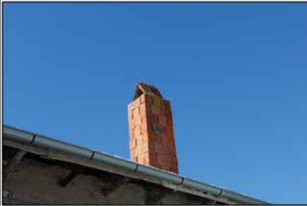
Fotoğraf 91: Delikli Tuğla ile Yapılan Baca / Chimney with Perforated Brick
