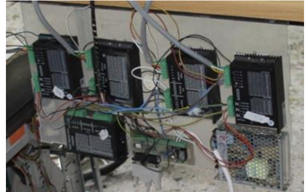
Şekil 9. Motor kontrol panosu
