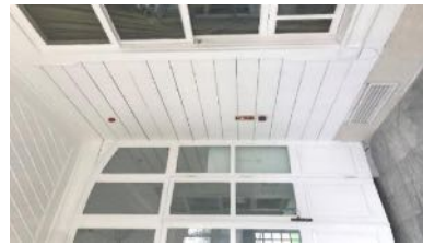
Şekil 37: Zemin Kat Kanal Çıkışı
