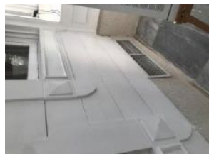
Şekil 36: Zemin Kat Kanal Çıkışı
