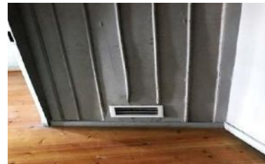
Şekil 39: Zemin Kat İç Mekan Kanal Çıkışı
