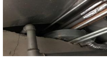
Şekil 43: Tesisat Odası Havalandırma Kanalı Çıkışları
