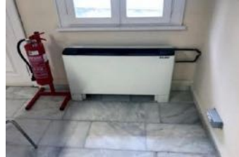
Şekil 46: Bodrum Kat Bekleme Odası (Fan-Coil)
