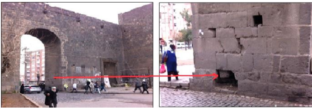
Şekil 7. Orta Kemerli Kapı (K2) batı yönünde meydana gelen malzeme kayıpları (2021)
