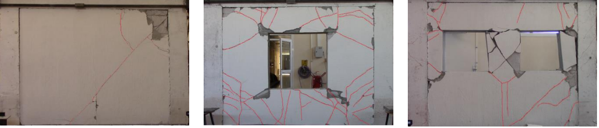
Şekil 11. %3,5 ötelenme oranında, dolgu duvarlarda meydana gelen hasarlar.
