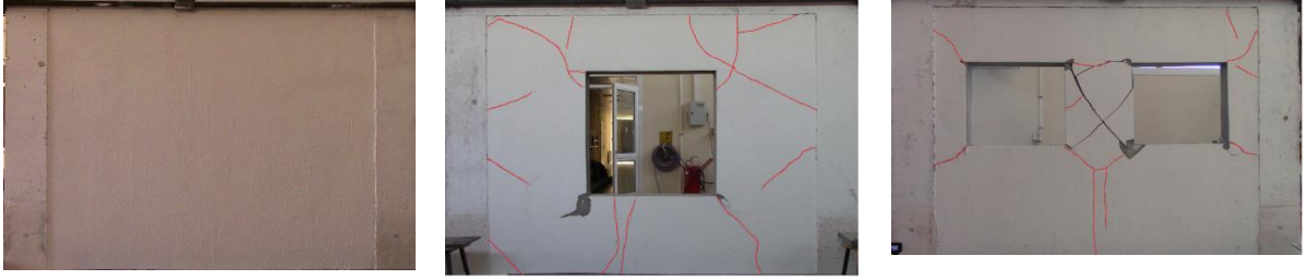
Şekil 10. %1 ötelenme oranında, dolgu duvarlarda meydana gelen hasarlar.
