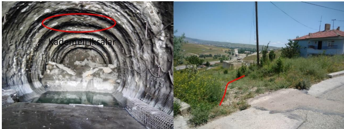
Şekil 7. T7 Tüneli Çıkış Portal kesimi tünel aynası ve yüzey çatlaklarının olduğu bölüm
