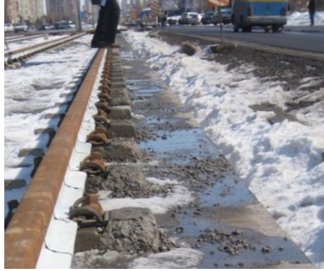
Şekil 2. Traverslerde buz çözücülerden kaynaklanan çatlama ve bozulmalar
