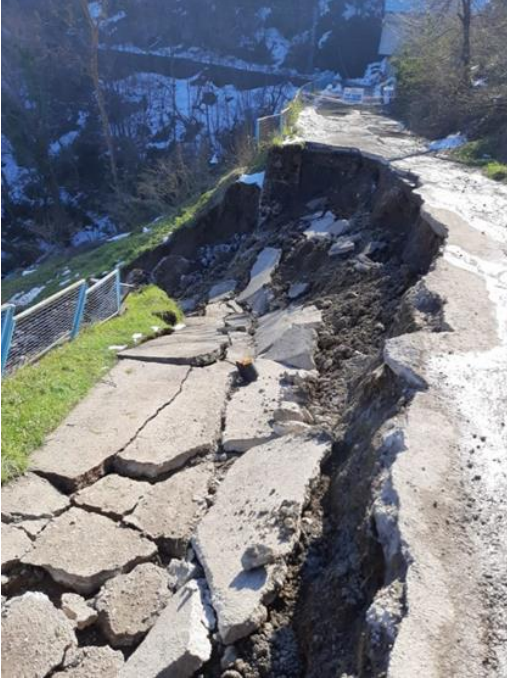
Şekil 10. Kozlu Kağızman Sokak-heyelan bölgesinden görüntü.
