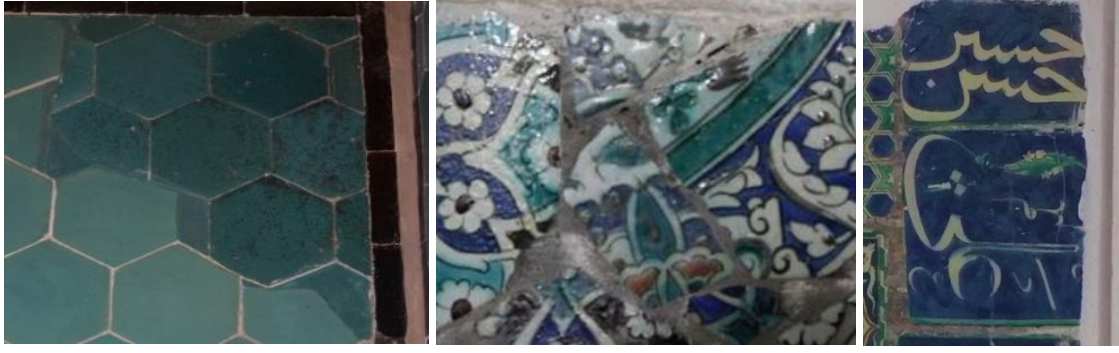
Resim 30. Konya Sahip Ata Halkah, onarımda hatalı birleştirme (Solda).
