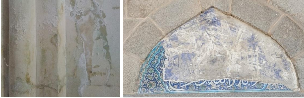
Resim 41. Kastamonu Küre-i Hadit Cami, onarımlardan sonra görülen leke (Solda).
