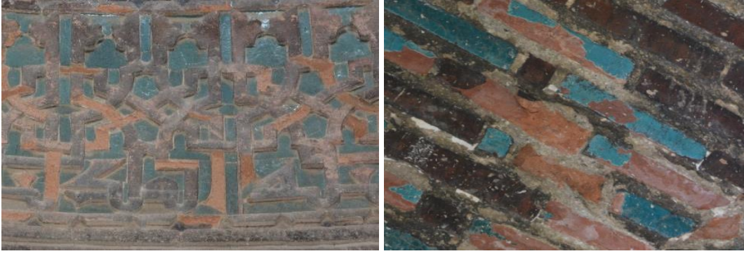
Resim 15. Konya İnce Minareli Medrese, Hamurda Aşınma-Ufalanma (Solda).
