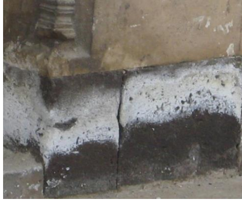
Resim 6. Van Hüsrev Paşa Cami, taşıyıcı duvarlarda çiçeklenme-tuzlanma (Belli, 2009: 181)
