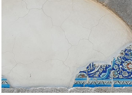
Resim 47. Erzurum Lala Paşa Cami, onarımlardan sonra görülen çatlak.
