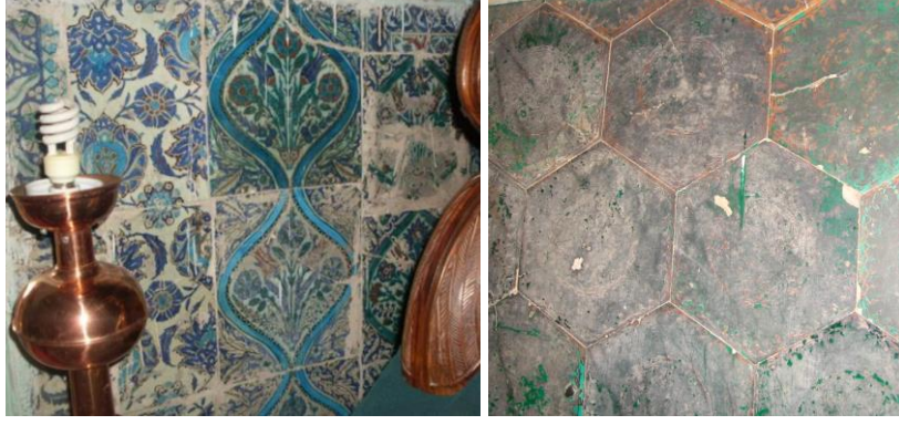
Resim 22. Diyarbakır Sahabeler Türbesi, sır yüzeyinde onarıma bağlı harç boya kalıntıları (Çığ, 2014: 10).
