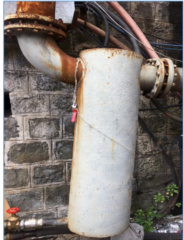
Şekil 8: Yağışma suyu tahliye tankı ve blöf musluğu
