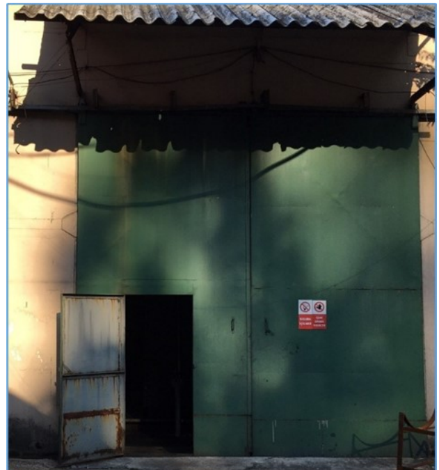
Şekil 3: Kompresör dairesinin kapıları
