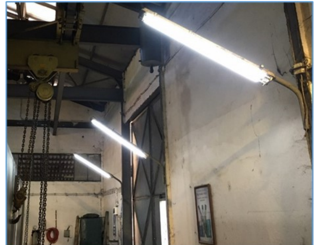
Şekil 10: Kompresör dairesinin aydınlatılması
