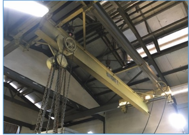
Şekil 5: Kompresör dairesindeki vinç sistemi
