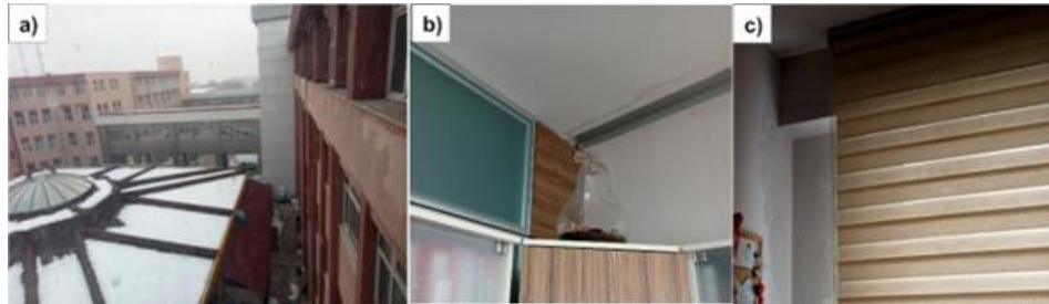
Şekil 5. (a) Binaların dış kabuğunda görülen döküntüler (b)-(c) oda duvarlarında yağışlı aylarda gözlenen su sızıntıları
