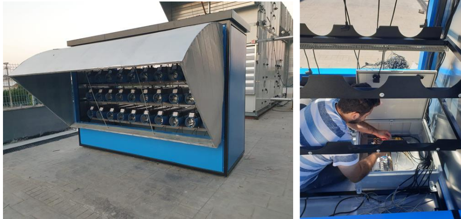
Şekil 6: HVAC Sistemine monte edilen UVC lambalar.
