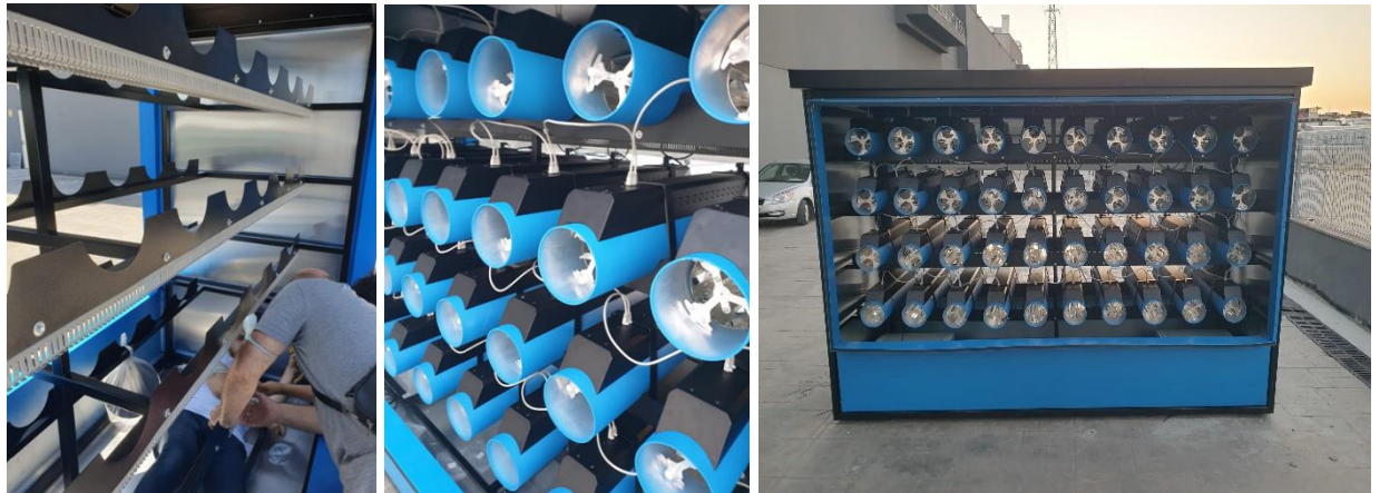
Şekil 7: UVC lambalarının monte edildiği HVAC sisteminin önden görünüşü.
