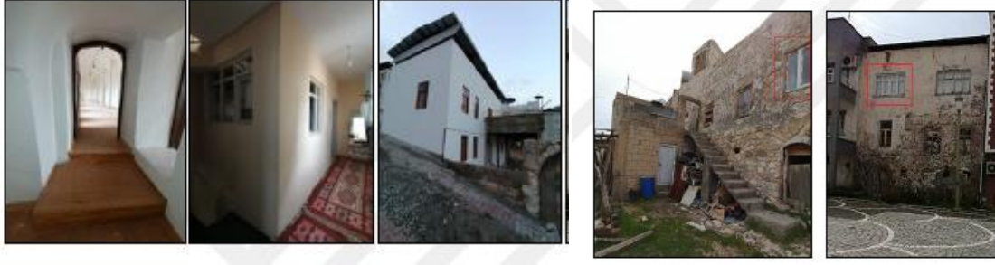
Şekil 19. Geleneksel Tillo evleri pencerelerinde PVC kullanımı ile iç ve dış duvarlarda suni boya kullanımı
