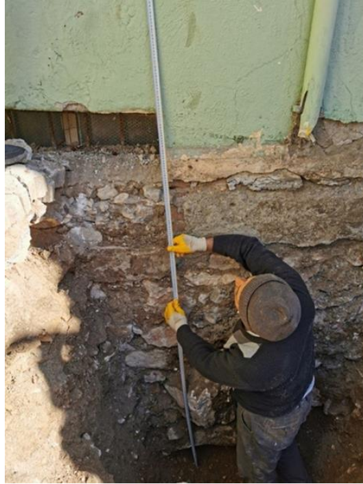
Şekil 4: Şeyhler Camisi batı cephesi yol kotu altında kalan pencere (Hekart Mimarlık'tan)
