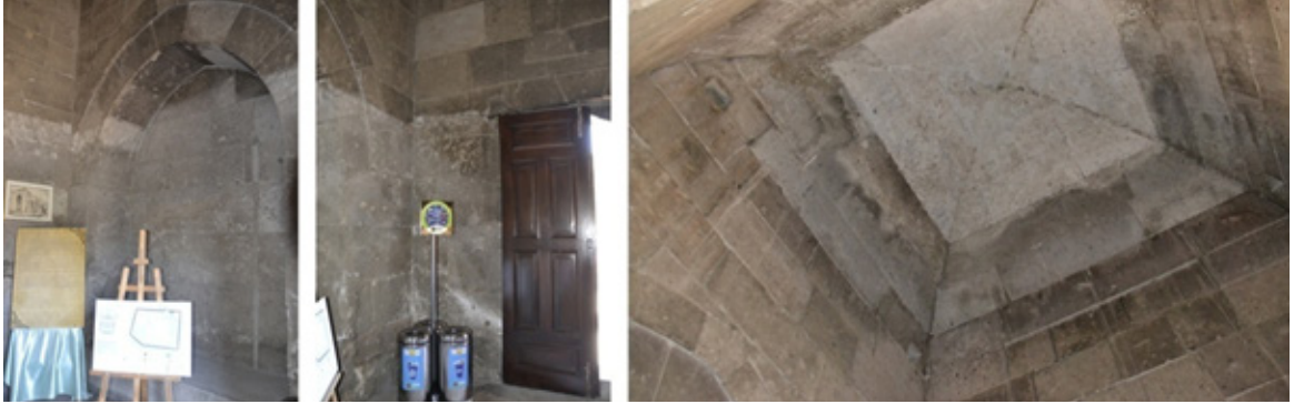
Fotoğraf 8,9,10: Giriş bölümünde gözlenen bozulmalar
