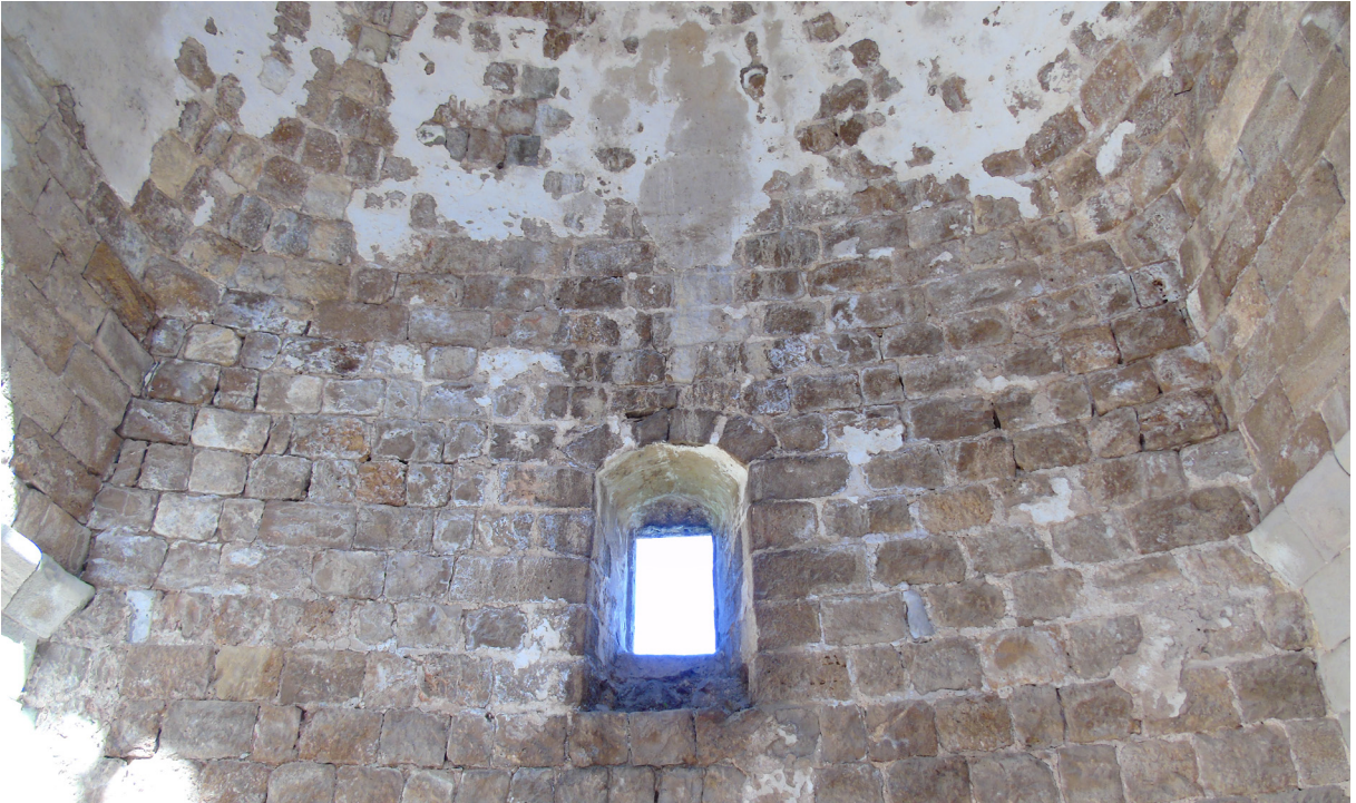
Şekil 11: Horan Bölümü Sıva Kalıntıları, 2019
