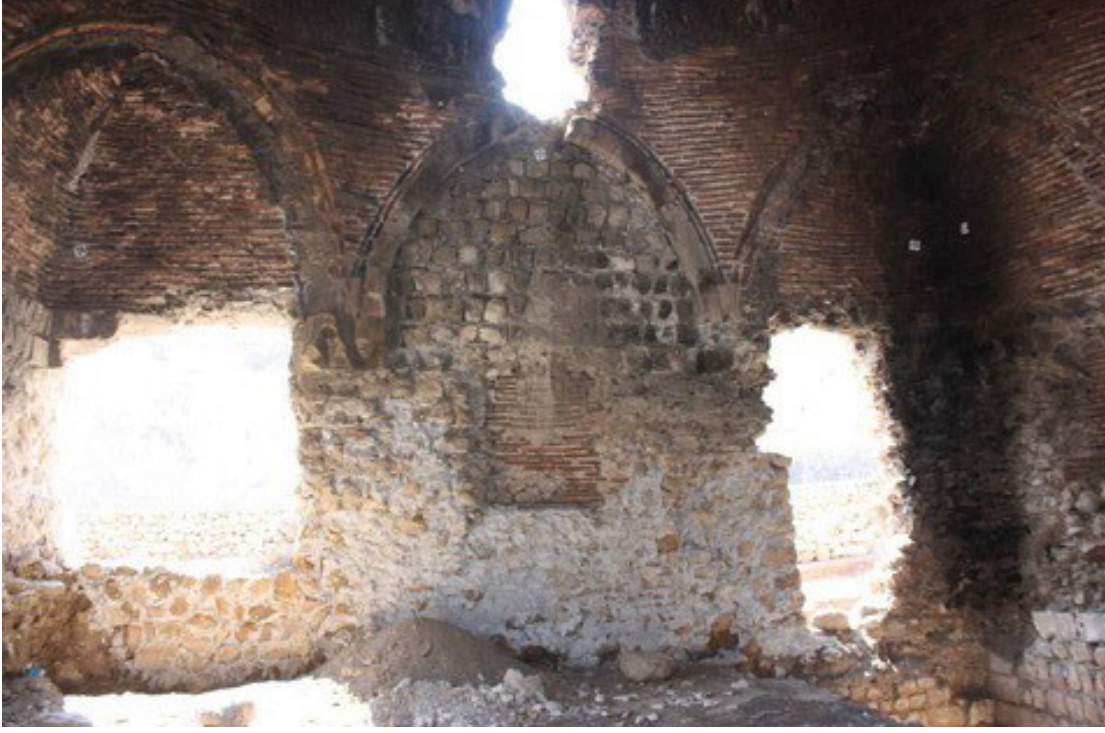
Resim 8: Hamamın Soyunmalık Güney Duvarı (KVMGM Arşivi)
