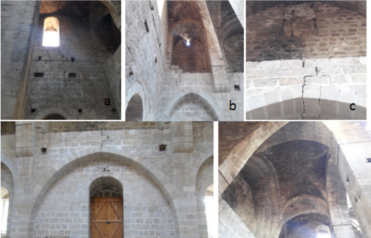
Şekil 9: İç Batı Cephede Oluşan Duvar Çatlağı, 2019
