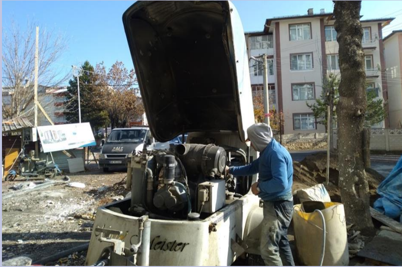
Şekil 5. Şantiyedeki Makinelerin Yetkisiz Kişiler Tarafından Bakım ve Onarım Yapılması Figure 5. Maintenance and Repair of Machinery on the Site by Unauthorized Persons
