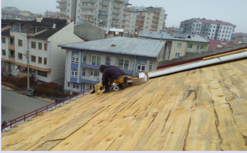
Şekil 3. Çatı ve Oluk Montajı sırasında Düşme Figure 3. Falling During Roof and Gutter Installation
