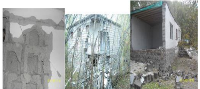
Şekil 2. Tipik Duvar Hasarları [6],[7]
