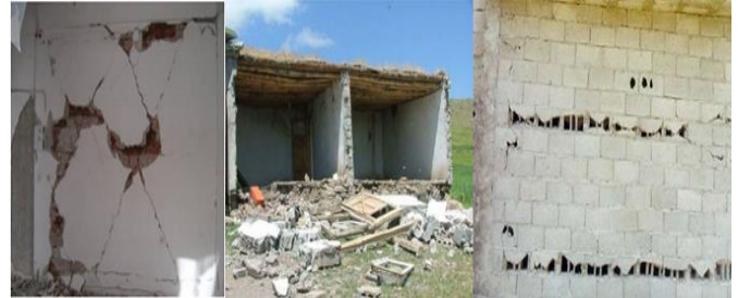
Şekil 1. Tipik Duvar Hasarları [7]
