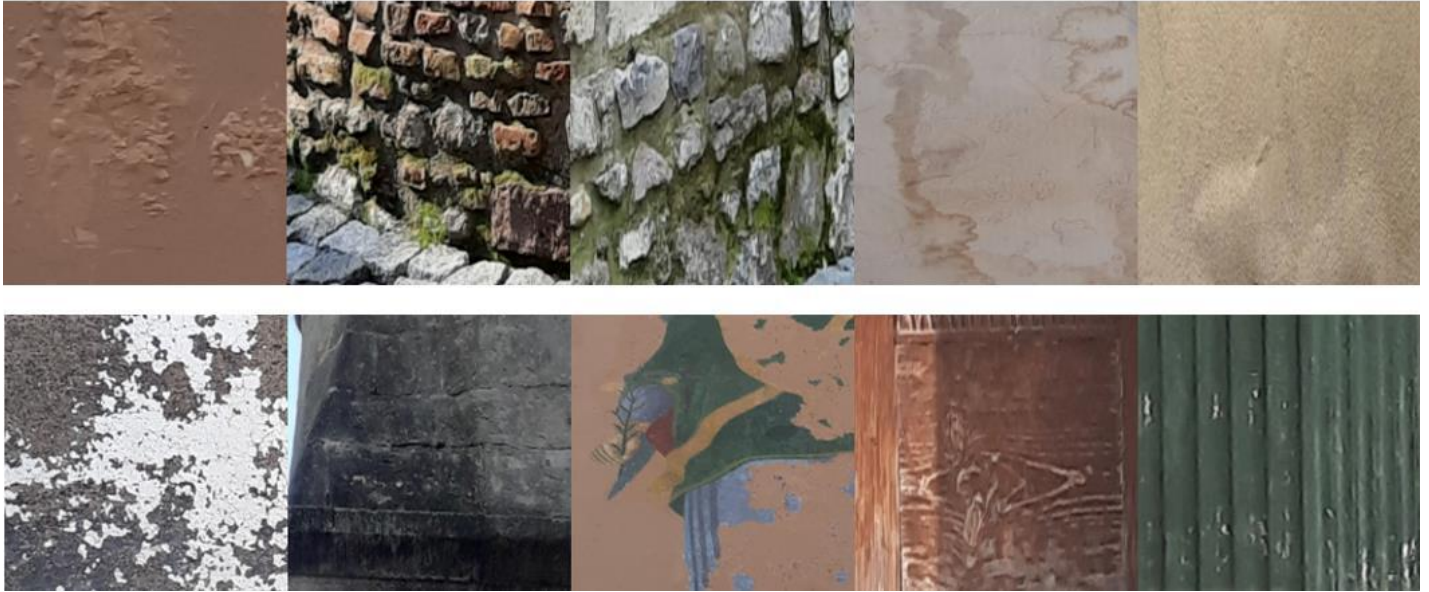
Şekil 1. Yapılarda Bazı Nem Hasarları ve Bozulmalar
