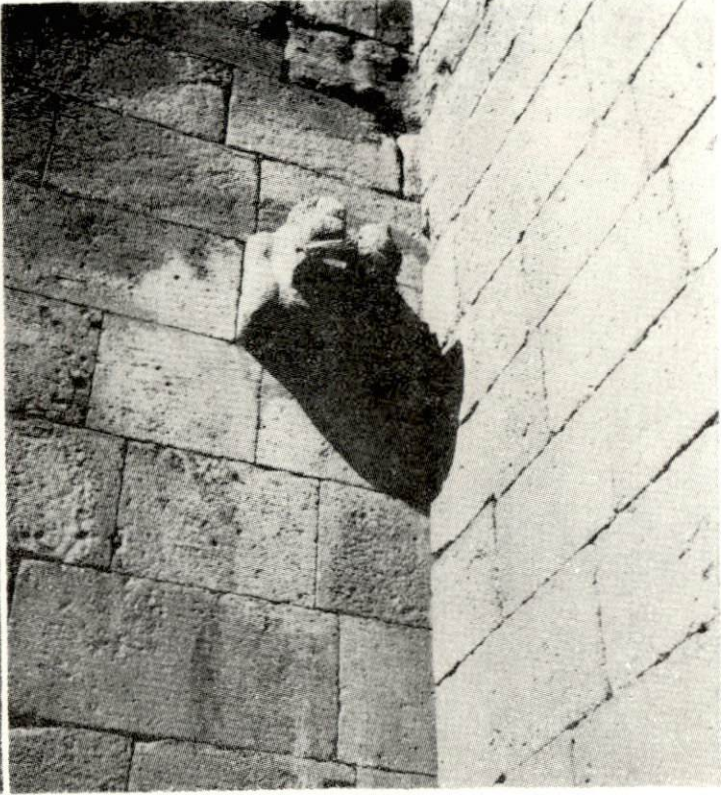
22. res. - Dışta câmiin batı duvarının medreseye bağlandığı köşedeki dilâtasyon.
