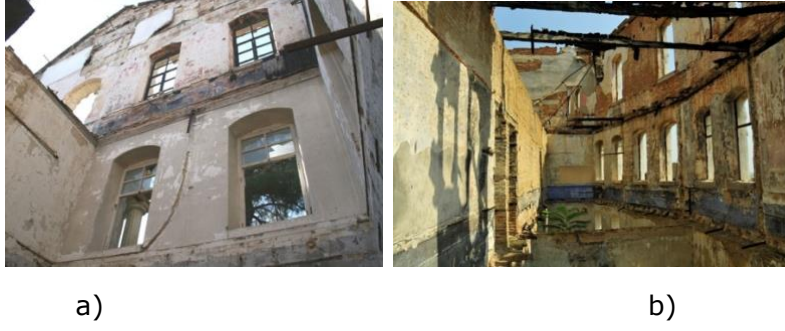
Şekil 6: Vali Faik Üstün İlköğretim Okulu'nun yangından sonraki durumu a) (URL 5); b) (URL 6)
