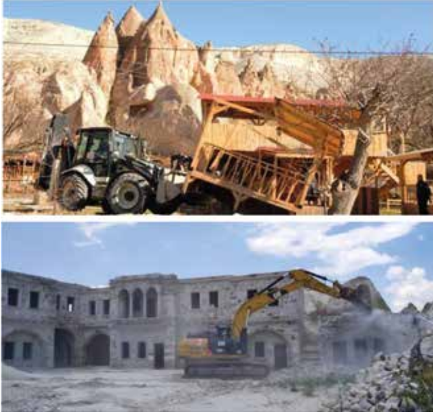
Fotoğraf 2: Kapadokya İmar Barışı uygulamasından yararlanabilmek için 2019'da yapılan kaçak yapılar (üst, URL 2; alt, URL 3) / Unlicensed buildings constructed during zoning amnesty in 2019 (Top, URL 2; Bottom, URL 3)
