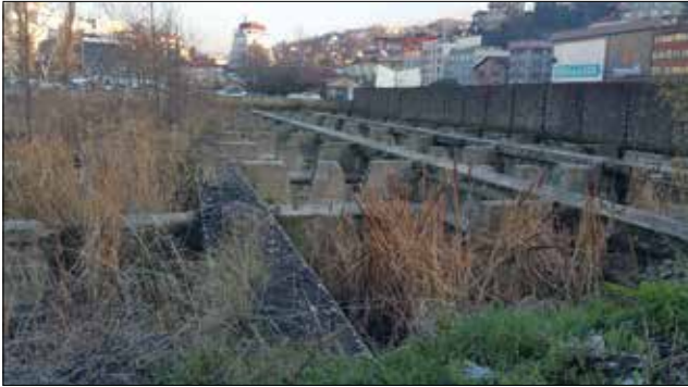
Fotoğraf 44: Merkez Lavuar Tesisi Silo Altı Yıkımdan Sonra (Merve Varol Can Arşivi, 03.01.2020) / Central Coal Washing Plant Under Silo (After Demolition)
