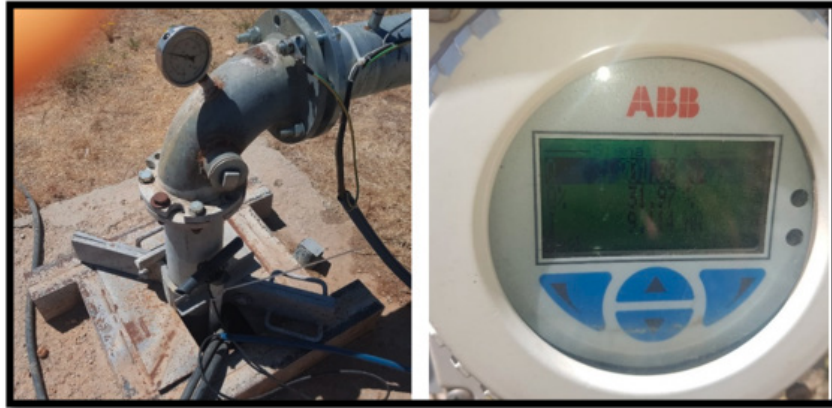
Şekil 9. Üretim kuyularına yerleştirilen debimetreler (EÜAŞ, 2020)
