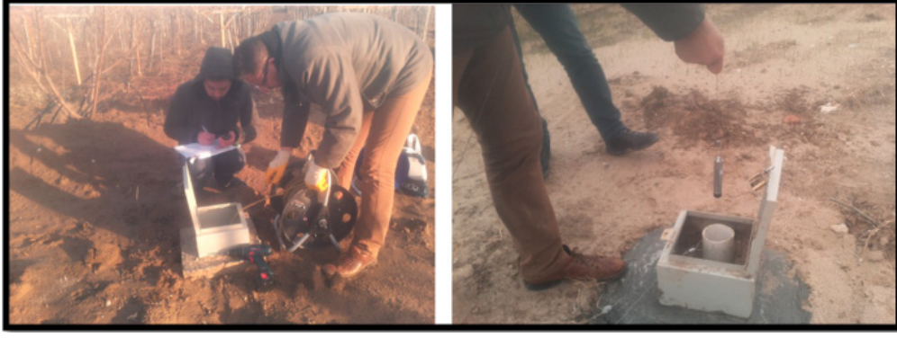
Şekil 10. Pompaj ve gözlem kuyularında debi ve seviyenin izlenmesi
