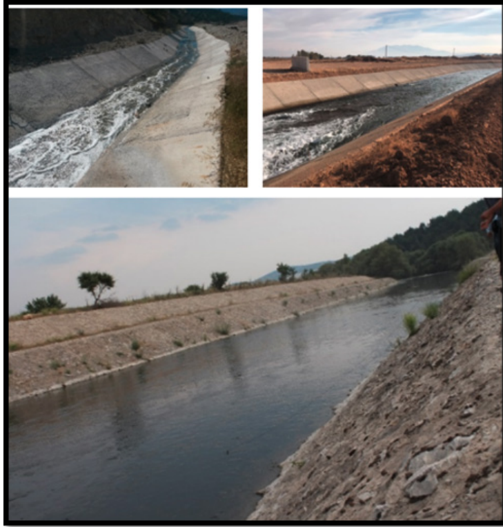
Şekil 6. İşletme sahasında suların kontrollü drenaj koşullarının ile drene edilmesi (ETİ, 2016; EÜAŞ, 2020)
