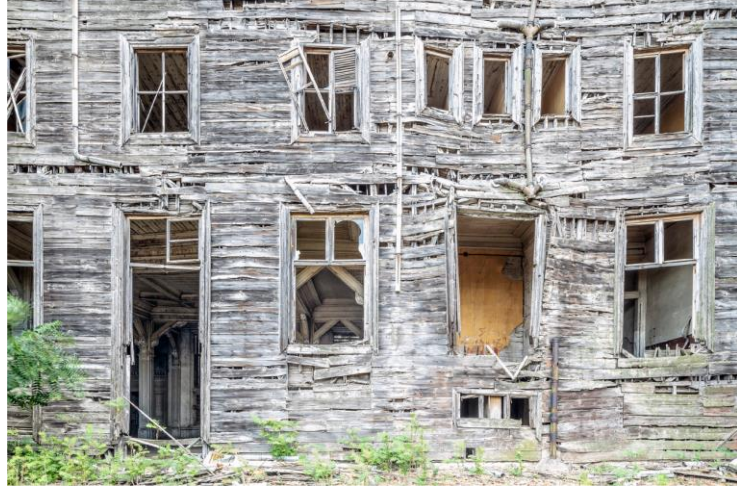
Şekil 8. Yetimhane Cephesindeki Bozulmalar (Germen 2018)
