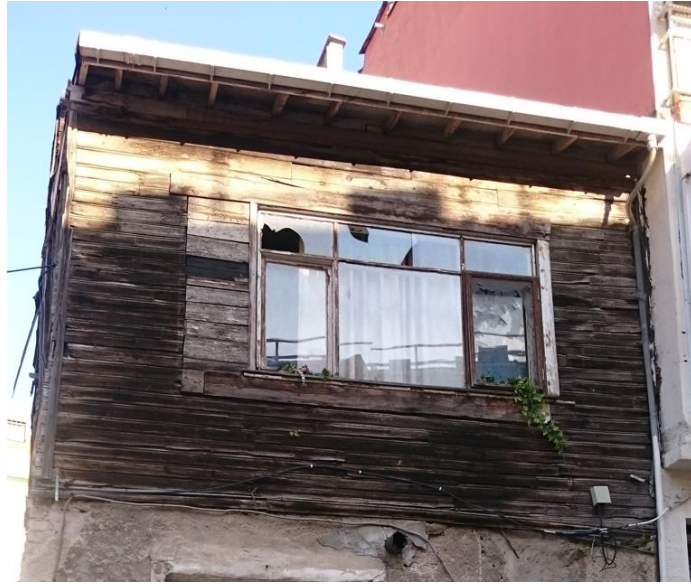
Şekil 2. Güneş Etkisiyle Ahşap Yüzeyde Oluşan Kararma
