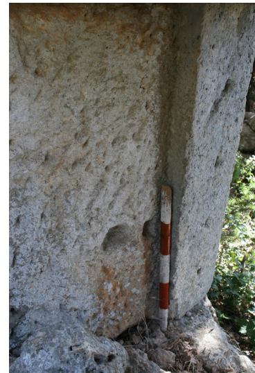
Fig. 8c. D30 No'lu Konut Ana Kapı Yanındaki Pencere Kilit Yuvaları.
