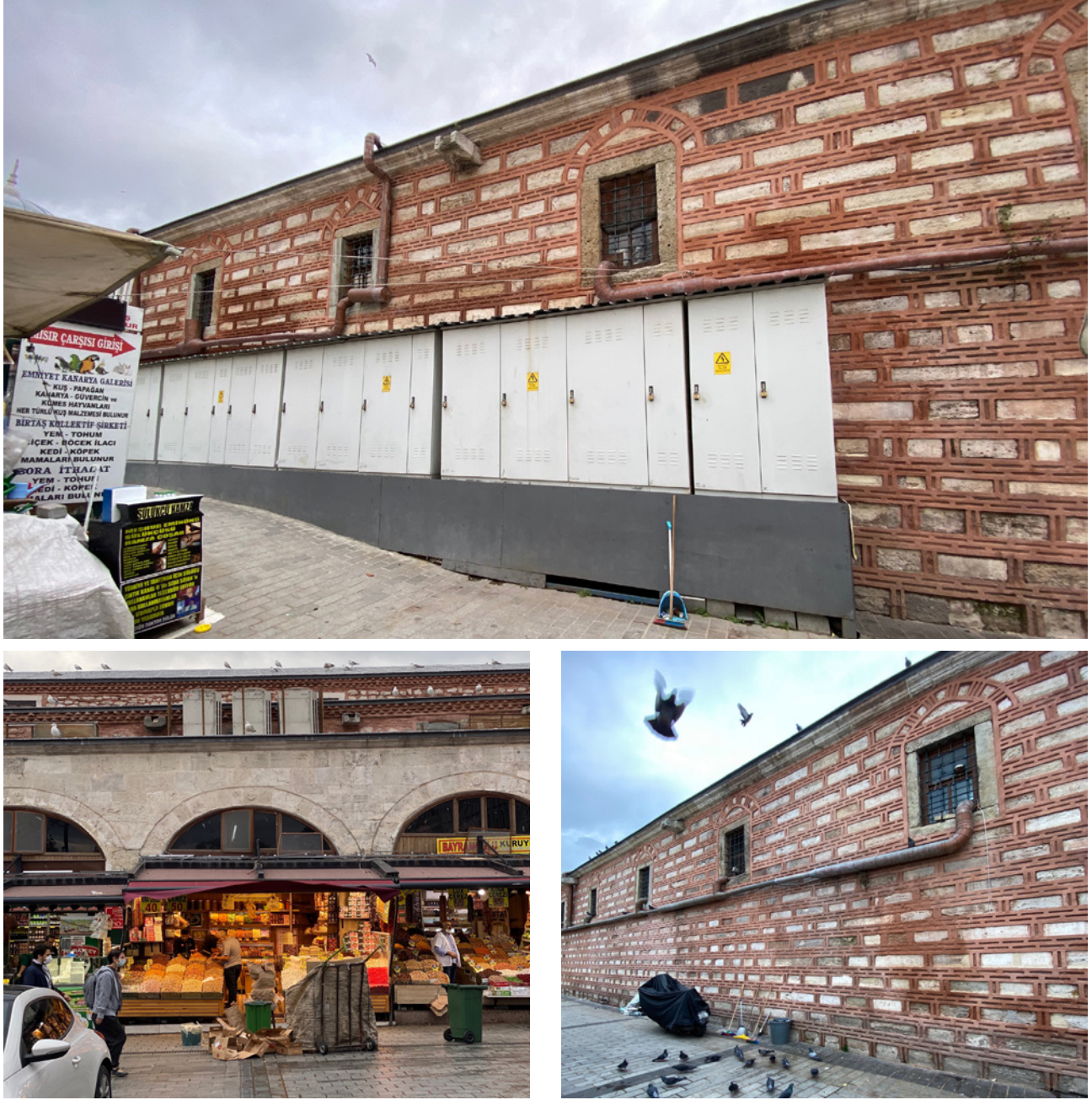
Şekil 6 Mısır Çarşısı'nda teknik altyapıya ilişkin sorunlar
