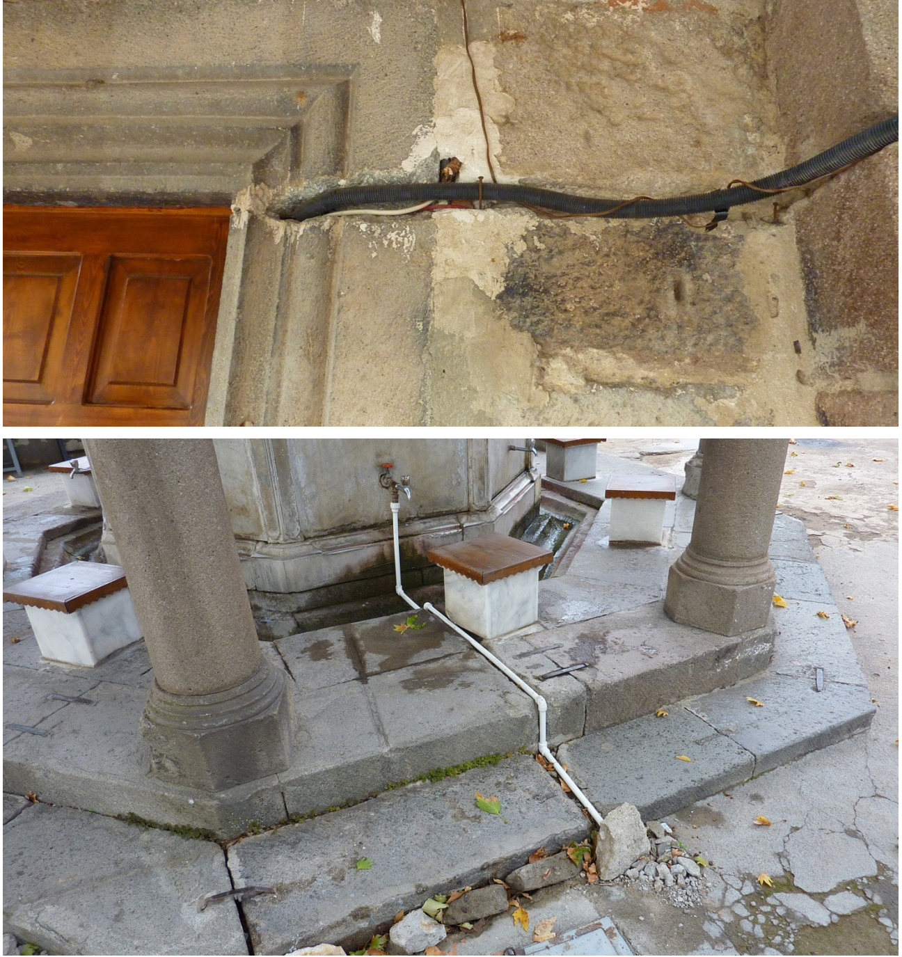
Şekil 5 Bergama'dan iki yapıda niteliksiz teknik altyapı uygulaması
