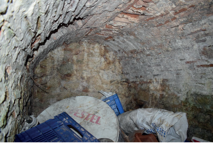
Fotoğraf 9: Akbaba Köyü Canfedâ Hatun Hamamı su deposu
