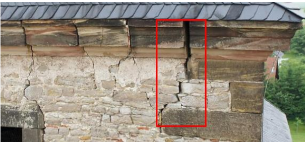
Şekil 29. Kritik çatlak tespiti (Morgenthal & Hallerman, 2014).
