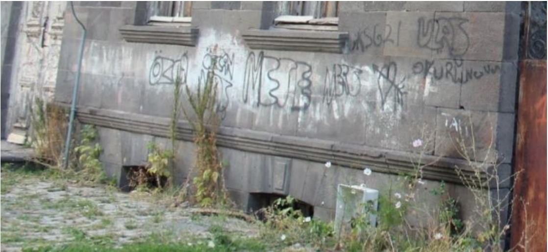
Fotoğraf 8: Topçu Evi dış cephede spreyle yapılan tahribat.
