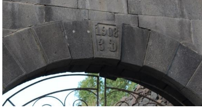
Fotoğraf 21: Dış cepheden görülen kemer bozulması
