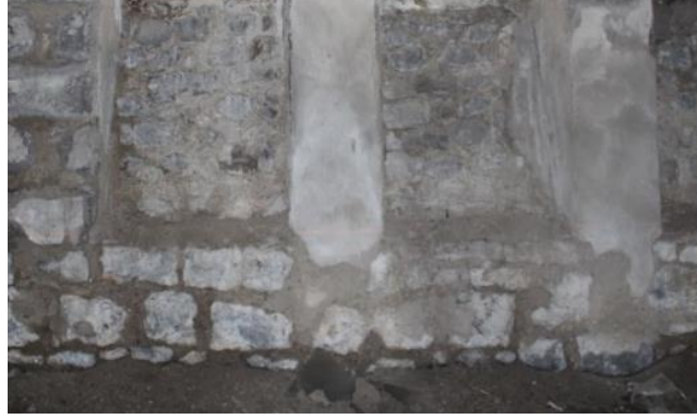
Fotoğraf 20: Moloz taş duvarlarda görülen nem ve buna bağlı oluşan bozulmalar
