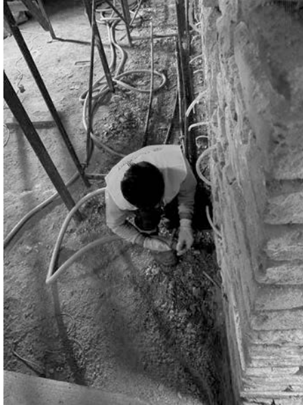
Şekil 1: Kağıthane Tarihi Çamaşırhane Binası'nda enjeksiyon yöntemi ile duvardaki çatlakların ve boşlukların doldurulması (Yazarın Fotoğraf Arşivi)
