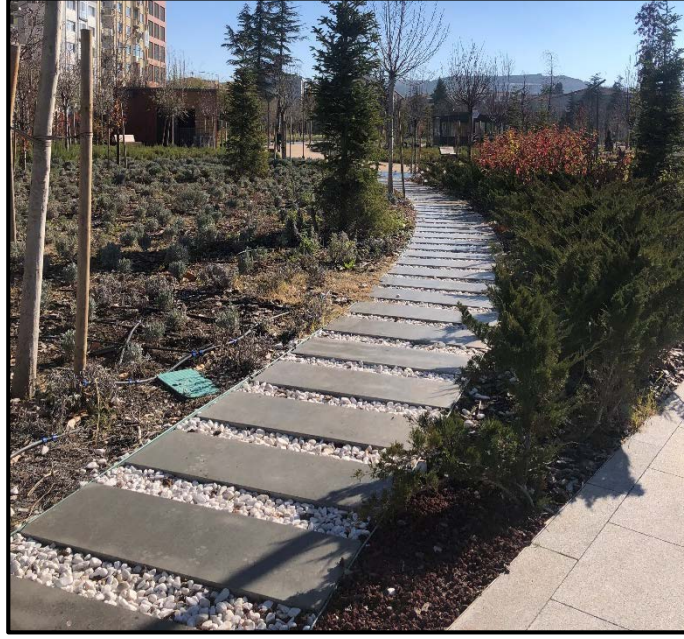
Şekil 20. Kaplama Malzemesi Açısından Sorun Oluşturan Gezinti Yolu (Kaynak: Yazarlara aittir.)
