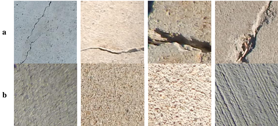
Şekil 1. Veri setini temsil eden örnek görüntüler a) Çatlak pozitif, b) Çatlak negatif [13]
