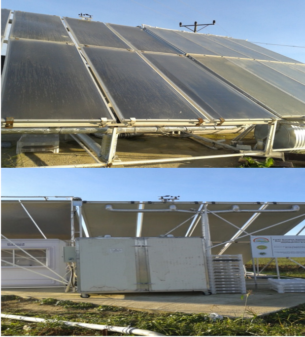
Şekil 4. Güneş kolektörlü kurutma sistemi Figure 4. Drying system with solar collector
