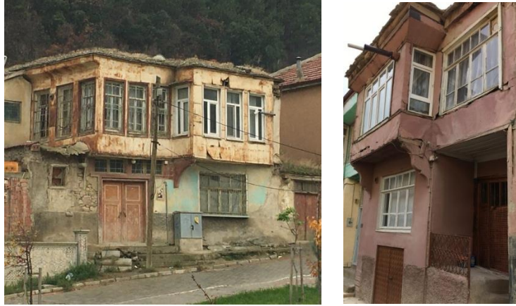
Şekil 6. Hasar görmemesi için cephenin teneke levha ile kaplanması (Yazar arşivinden)
