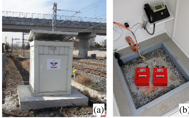
Şekil 2. Yerköy-Sivas Hızlı Demiryolu Projesi'nde (a) ivme ölçerlerin yerleştirildiği dolaplar ve (b) dolaplar içerisinde yer alan kuvvet dengeli ivme ölçerler
