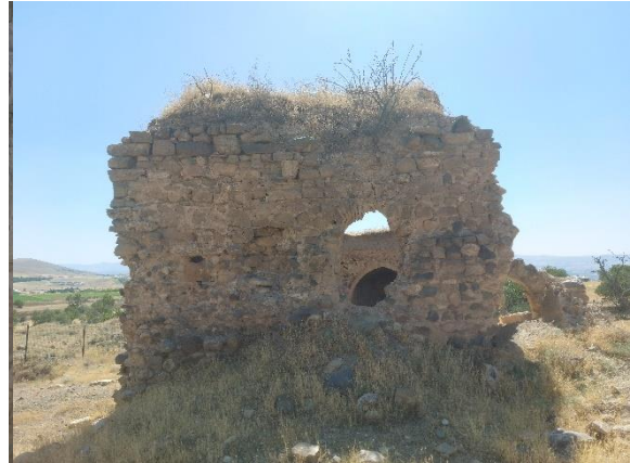
Şekil 10. Malzemede oluşan renk kararması ve bitki oluşumu (2022)
