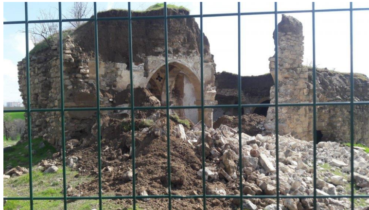
Şekil 7. Kısmi yıkılma sonrası kuzeybatı cephesi (URL-6, 2022).
