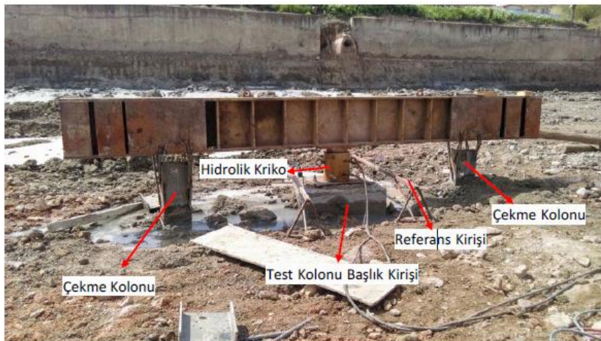
Şekil 3. İnceleme Alanına Ait Yükleme Deney Düzeneği (Can ve Acar, 2016) (Loading Test Setup Belonging To The Study Area)
