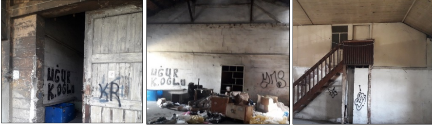
Görsel 12. Ambar binasında görülen Vandalizm örnekleri (Yazar, 2020; bu görseller yazarlar tarafından çekilmiştir)
