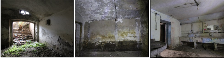
Görsel 10. Ambar binası bodrum kat mahallerinde görülen malzeme bozulmaları (Yazar, 2020; bu görseller yazarlar tarafından çekilmiştir)
