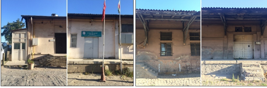
Görsel 5. Gümrük binası (sol), ambar binası (sağ) güney cephesi (Yazar, 2020; bu görseller yazarlar tarafından çekilmiştir)
