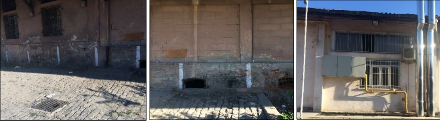
Görsel 13. Yapı bloğunun güney cephesinde görülen niteliksiz müdahaleler ve ekler (Yazar, 2020; bu görseller yazarlar tarafından çekilmiştir)
