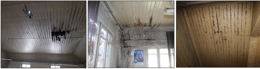
Görsel 9. Ambar binası zemin kat mahallerinde görülen malzeme bozulmaları (Yazar, 2020; bu görseller yazarlar tarafından çekilmiştir)
