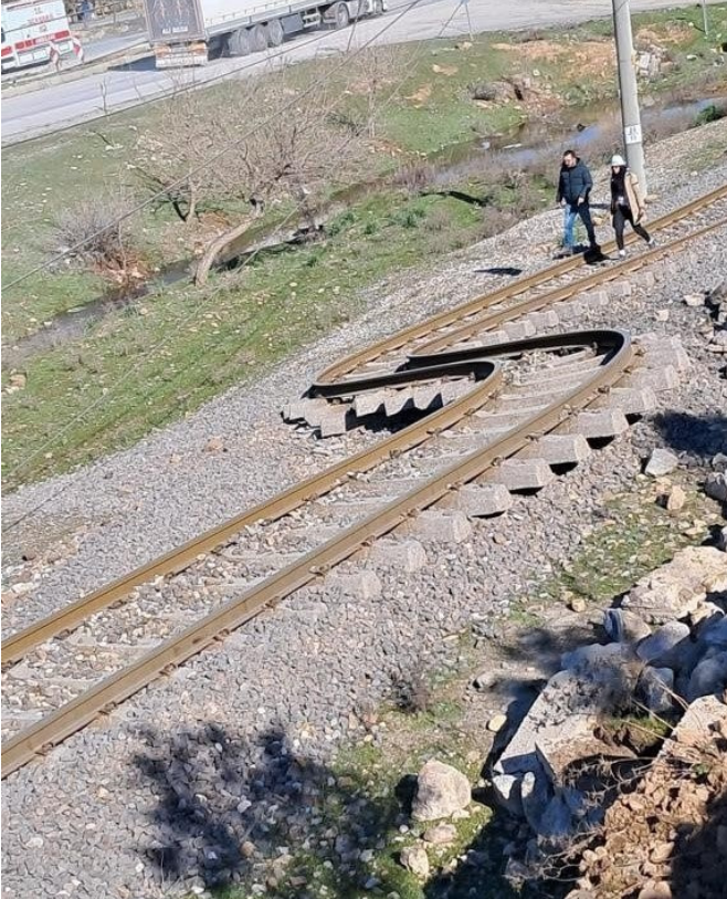
Fotoğraf 3. Deprem rayları kıvrımlı bir hale getirmiştir (A Haber, 2023). Photo 3. Earthquake made the rails curvy (A Haber, 2023).
