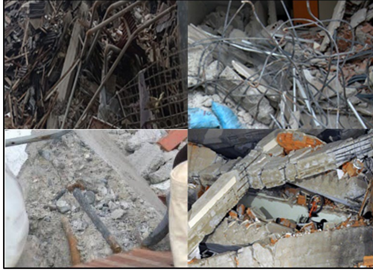
Şekil 4: Deprem sonrası yıkılan binalardaki donatıların durumu Figure 4: Condition of reinforcements in buildings destroyed after the earthquake
