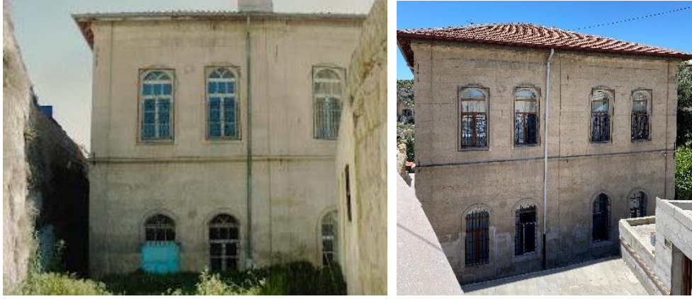
Görsel 17. Yapının Doğu Cephesinde Sonradan Kapıya Çevrilen Pencere ve Restorasyon Sonrası Özgün Durumu.
