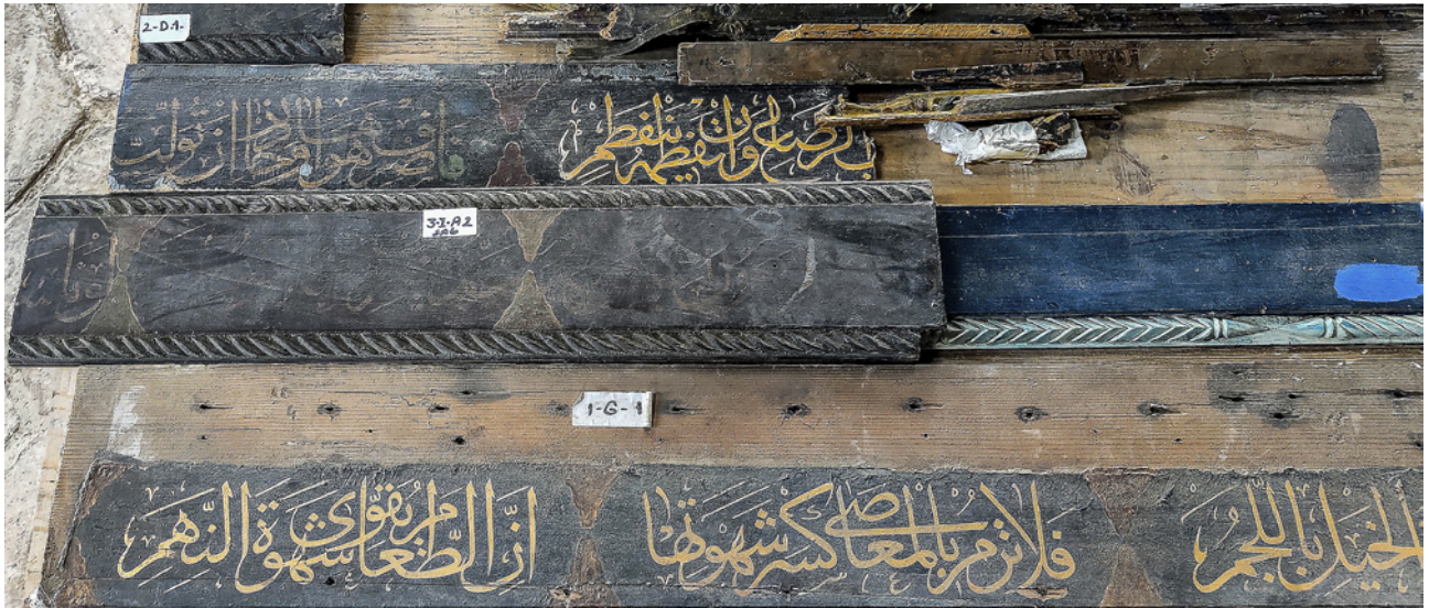
18 Restorasyonda değiştirilen nitelsiz yazı kuşağı parçaları
