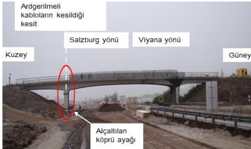
Şekil 6. S101 Üstgeçit köprüsündeki hasar testine genel bakış (VCE, 2009)
