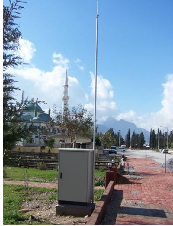
Şekil 12. Su dağıtım şebekesi üzerindeki bir çevrimiçi ölçüm ve veri aktarma istasyonu
