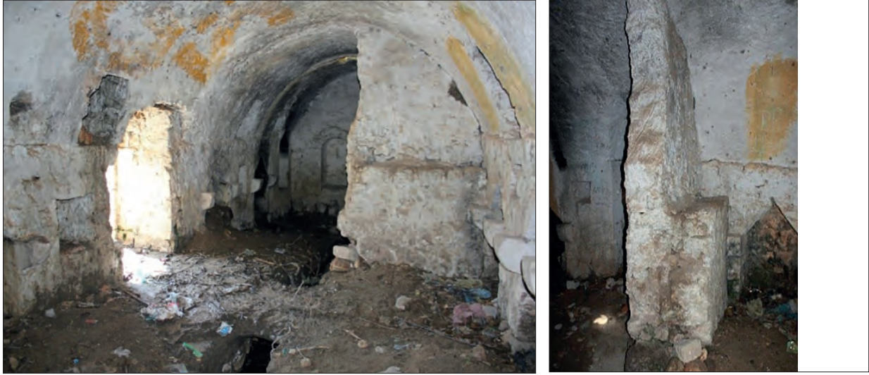
Fotoğraf 7. Aynül Meydan Çamaşırhanesi kısmen yıkılmış ara duvarı / The partially destroyed partition wall of Aynül Meydan Laundry (Doğru, 2019).
