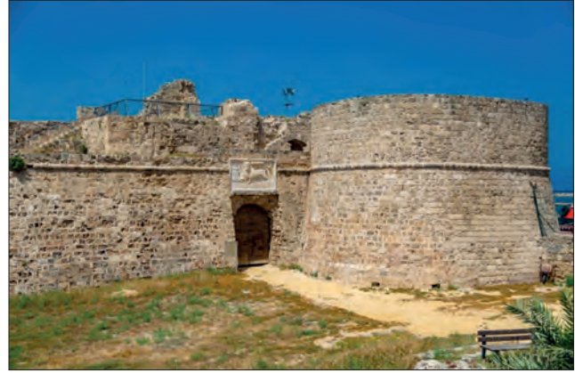
Fotoğraf 9. Gazimağusa kalesinde profilli silmeler / Profile cornices in the Famagusta castle . (URL 3)
