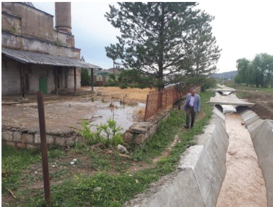
Görsel 10. Sel sonrası avlu ve çevre duvarına etkisi
