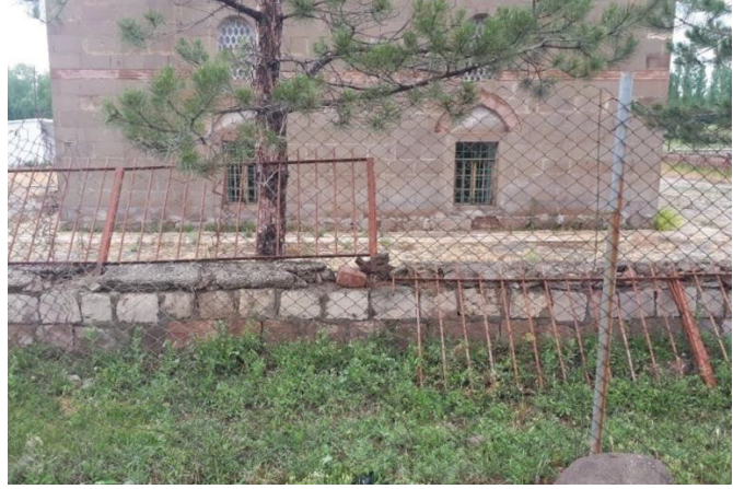
Görsel 13. Açısını kaybeden duvarla devrilen duvar korkuluklar
