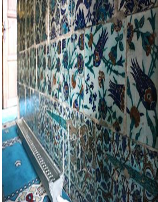
Şekil 28: Sahabeler Türbesi güney Duvarı.
