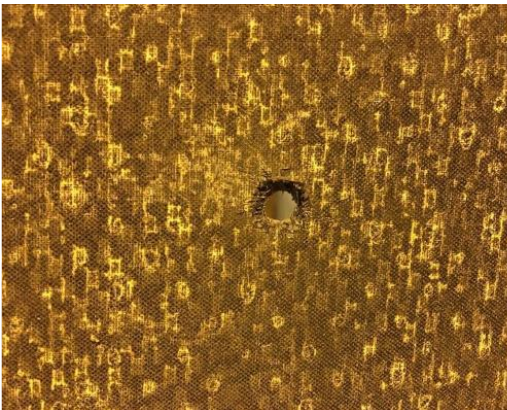
Şekil 12: Hasarlı bölgenin görüntüsü
