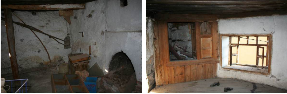
Fot. 34-35: Değirmenlik Köyü Seyit Efendi Odası Alt Kat ve Üst Kattaki Odaların Görünüşü
