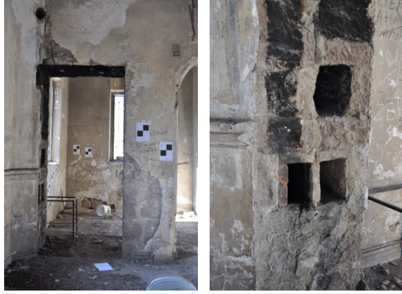
Görsel 16: Kilisedeki Soba Yerlerinden ve Havalandırma Kanallarından Bir Görüntü
