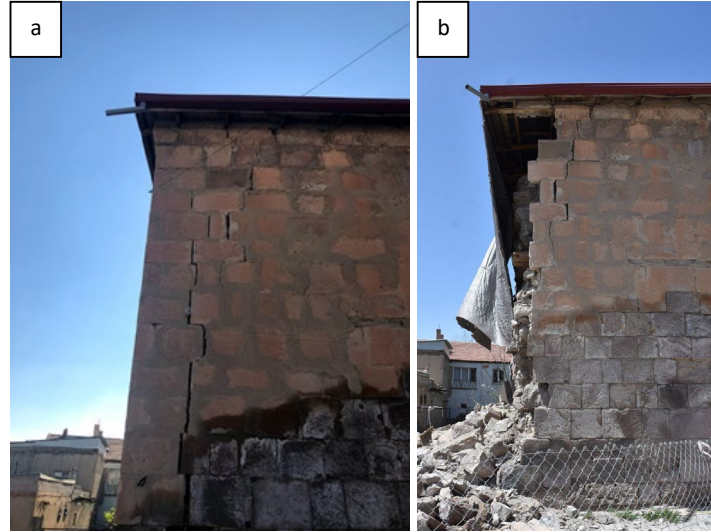
Şekil 15. Güney ve Doğu Cephelerinin Birleşim Yerinde Oluşan Çatlak, 2019 yılı (a), 2022 yılı (b)
