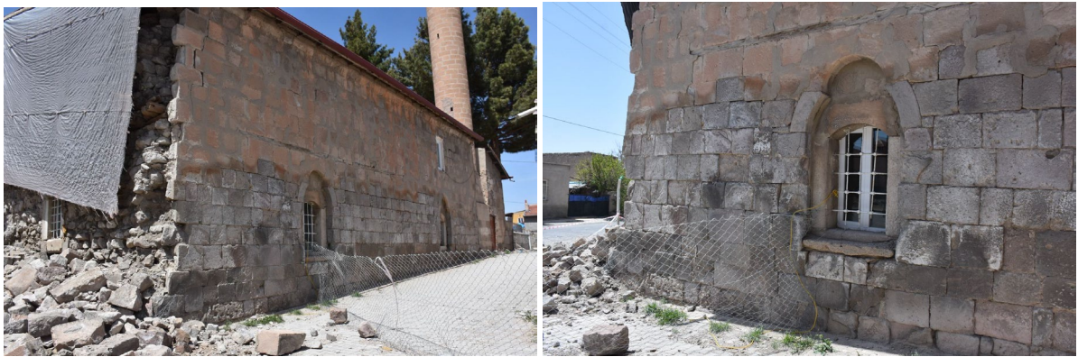
Şekil 16. Doğu Cephesindeki Duvarda Bozulmalar, 2022
