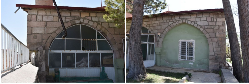
Şekil 17. Kuzey Cephesindeki Duvarda Bozulmalar, 2022
