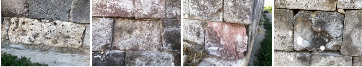
Şekil 19. Taş Bozulmalarından Örnekler; soldan sağa Oyuklanma (Alveol) Oluşumu, Ayrışma, Renk Değişimi ve Ayrışma, Tuzlanma ve Ayrışma, 2019
