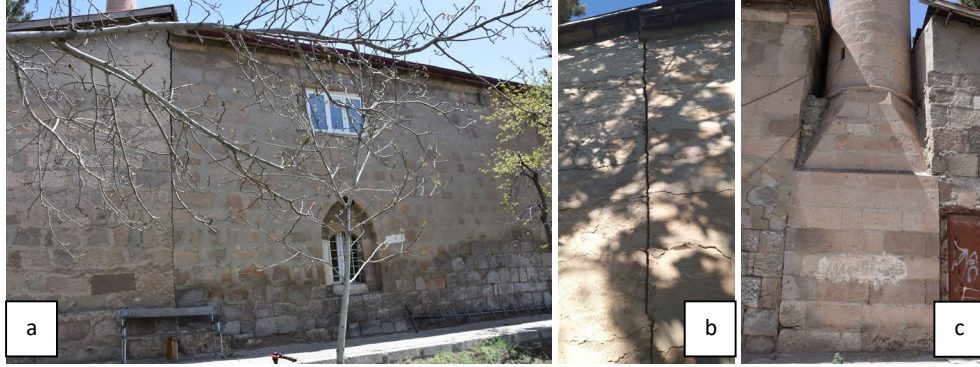
Şekil 21. Özgün Yapı ile Son Cemaat Bölümü Arasında Oluşan Derz (a), (b), Minare ile Yapı Arasında Oluşan Boşluklar (c), 2019
