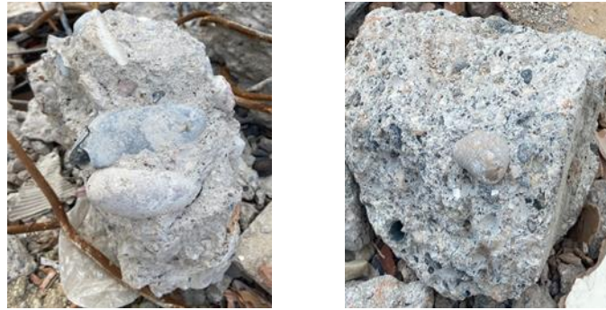
Şekil 4. Maksimum agrega boyutu büyük ve düşük dayanımlı beton
