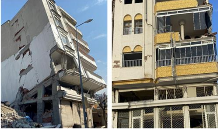
Şekil 14. Kısa kolonlarda oluşan hasarlar
