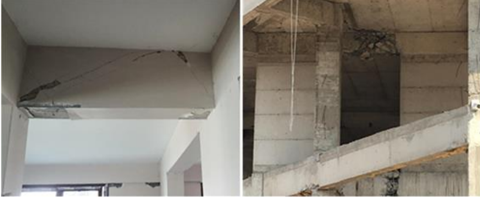
Şekil 15. Kısa kirişlerde oluşan hasarlar
