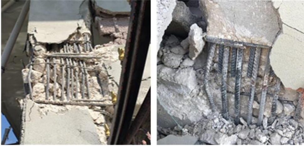
Şekil 12. Kolon elemanlarda yetersiz sayıda ve yanlış etriye kullanımı sonucu oluşan hasarlar
