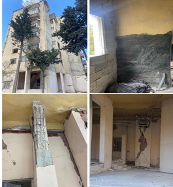
Şekil 16. Güçlendirilmiş bir yapının depremden sonraki durumu ve oluşan hasarlar
