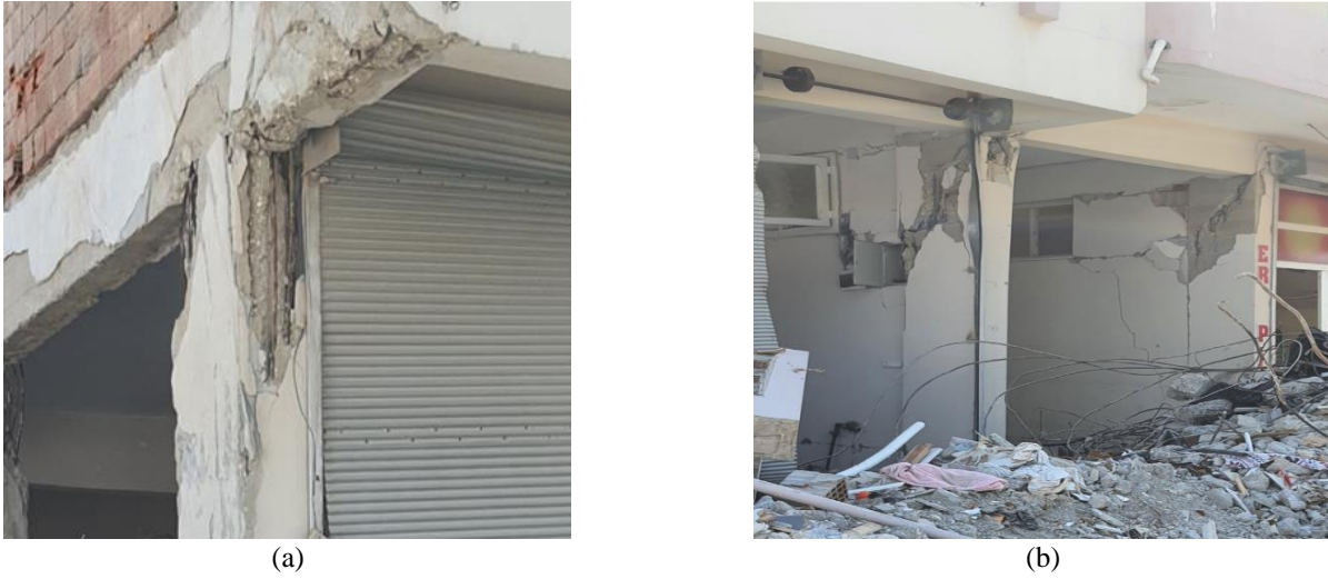
Şekil 13. a) Kolon-kiriş birleşim bölgesinde etriye kullanılmayan bina. b) Binanın diğer kolonlarında oluşan kesme çatlakları
